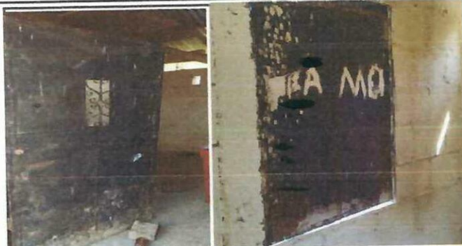
Foto 2: Sustrucción de puertas y ventanas
